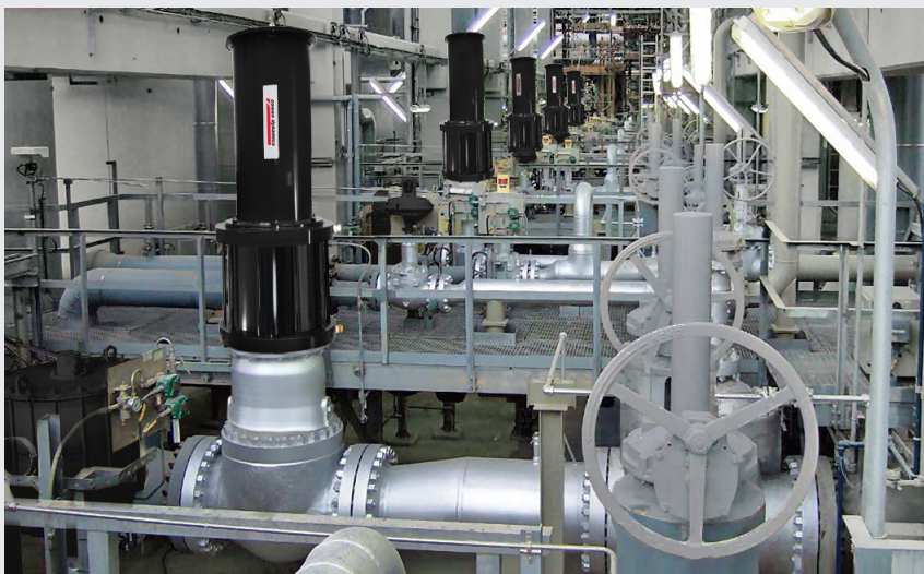
Modèle AS à fermeture en cas de défaillances sur vannes d'isolement de vapeur dans un générateur de vapeur à récupération de chaleur d'une centrale de production d'énergie américaine.
